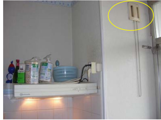
Ventilatiesysteem in een muur
