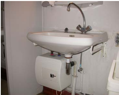
Elektrische waterverwarmer net voor de kraan
