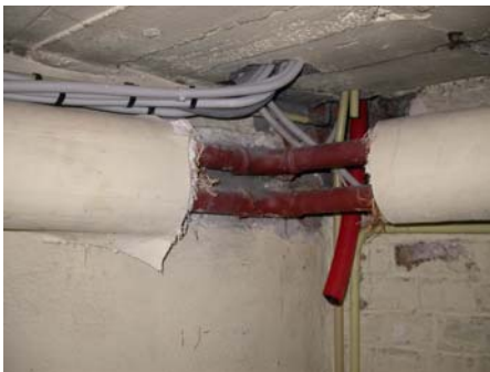
Voorbeeld van isolatie
