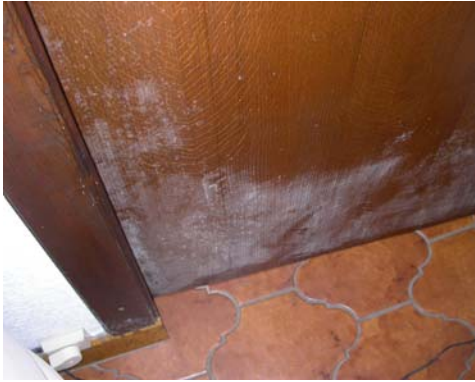
Schimmels onderaan een deur
